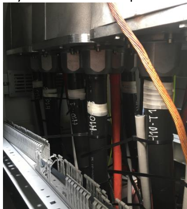
Figura 4 Switchgear son sensores instalados
