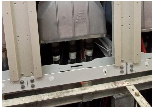
Figura 5 Switchgear son sensores instalados
