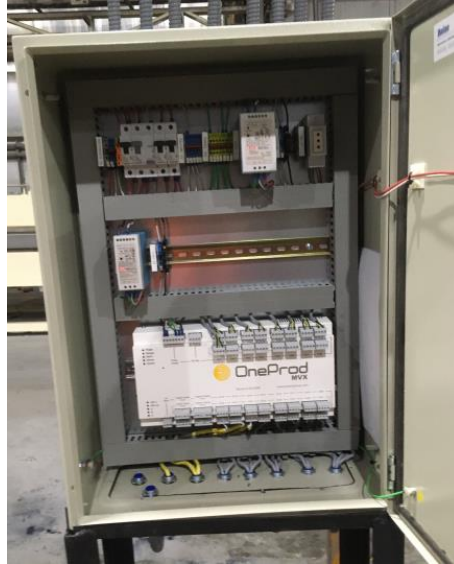
Figura 6 Gabinete instalado en línea de operación
