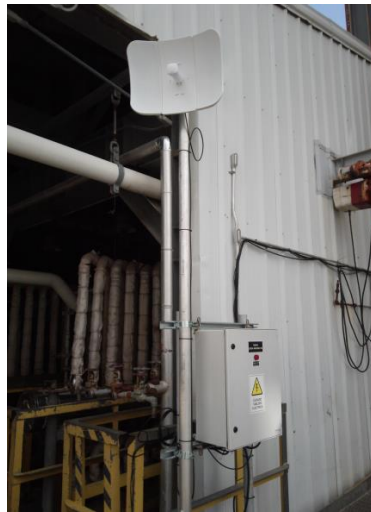
Figura 7 Gabinete con antena de comunicación
